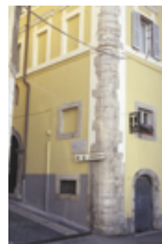
Il recente restauro pur prestando attenzione alle finiture, "ritaglia" l'intonaco all'angolo per lasciare in vista le pietre di costruzione
