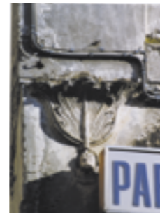
Particolare decorativo di una facciata realizzato in malta ed intonaco
