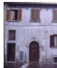
Il prospetto presenta infissi differenti e alcuni alterati da nuovi davanzali. In questo caso basterebbe omogeneizzare tipo e colore degli infissi (portoni, finestre, vetri, grate metalliche etc.)
