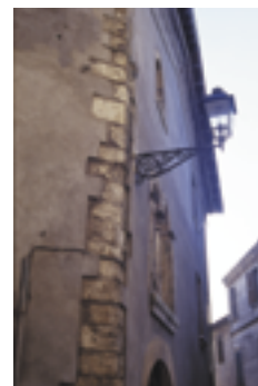
Oltre all'angolo lasciato a vista, l'intonaco di rivestimento non rispetta le quote originarie e sporge rispetto ai particolari lapidei
